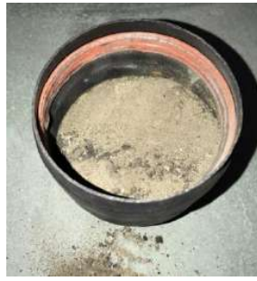
Beispiel eines verschmutzten Deckels
