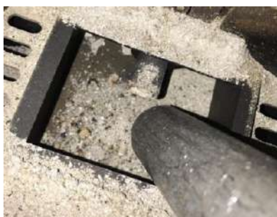
Beispiel eines verschmutzten Bodens
