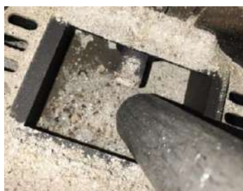
Příklad znečištěné základny
